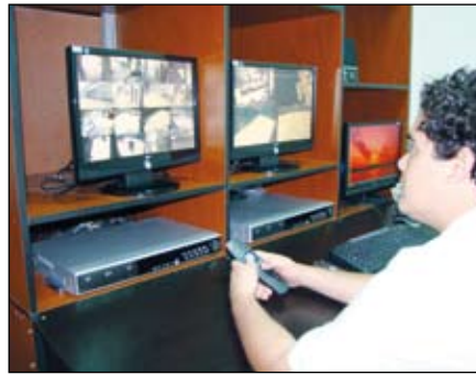
Sala de monitoreo central.
